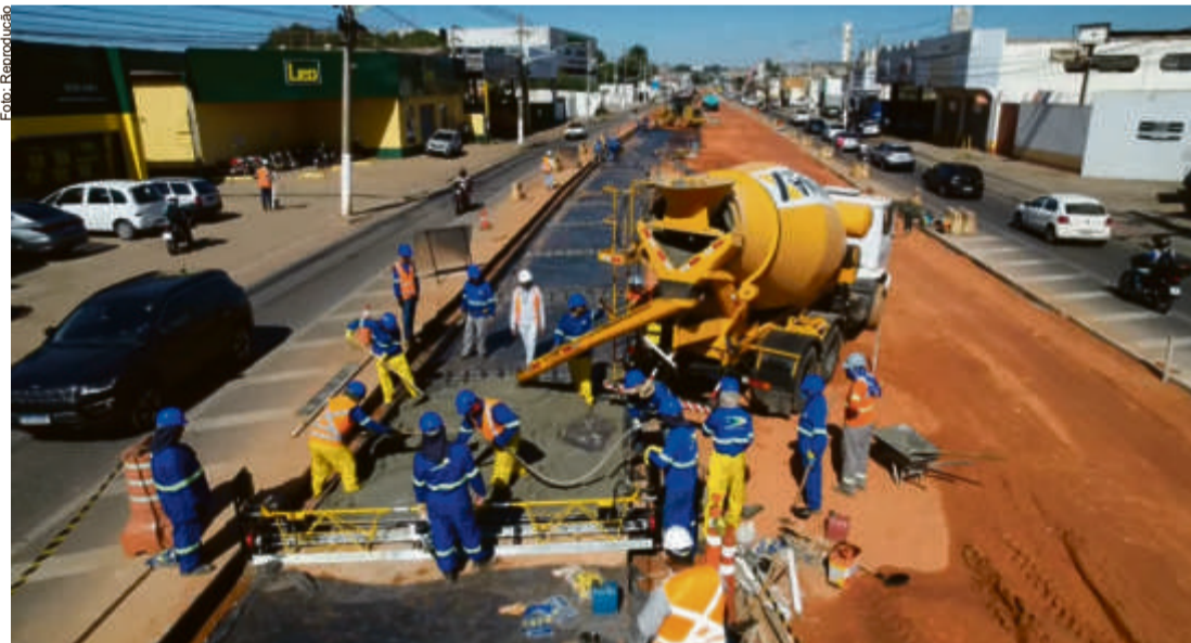
Obras paralisadas: a suspensão das intervenções no sistema viário de Várzea Grande para a implantação do BRT já era esperada antes mesmo de começar por conta da forma como o Governo do Estado impôs a mudança do VLT para o modal rodoviário na cidade
