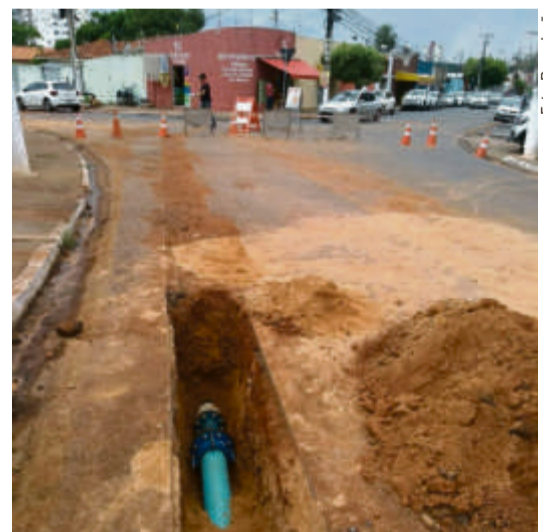
Município planeja que, já neste ano, a cidade chegue a um índice de 61% de cobertura da rede coletora de esgoto
