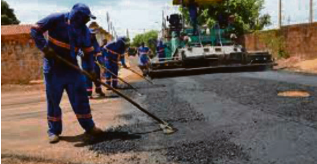
Neste ano, gestão alcançou marca histórica de aproximadamente 300 quilômetros de asfalto novo construído em todas as regiões da cidade
