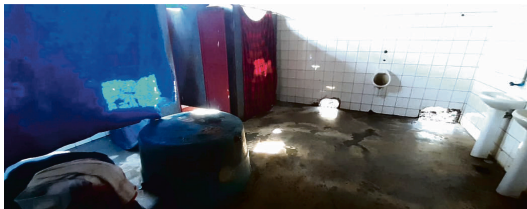
Prefeitura arrumou vasos do banheiro e chuveiros para banho, mas a situação é caótica e insalubre
