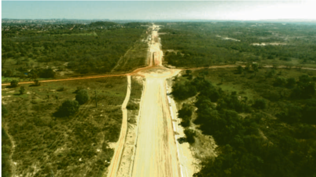
Conforme o projeto, a via terá 17,3 quilômetros de pista dupla, cada uma delas constituídas por duas faixas de rolamento, de 3,60 metros, e acostamento
